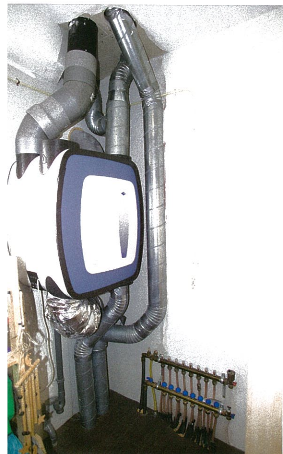
isventilatie, hier van het merk ITHO, houdt het nklimaat op niveau door de warmte van de ijekte lucht te benutten om de vers aangezogen alvast op temperatuur te brengen.
